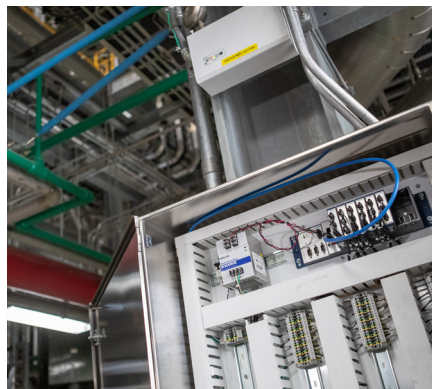
발전소에 설치된 산업용 인클로저에 있는 CompactRIO
